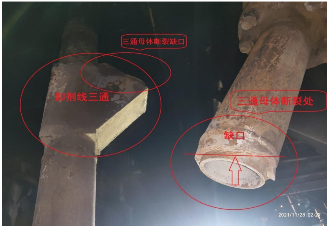
图4 卸剂线三通断裂缺口
